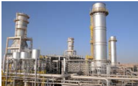
HRSG Project for NeM/Oxy Mukhaizna
